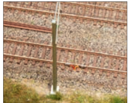
Gut zu erkennen: Trennstelle mit den beiden zum BM1 führenden Anschlüssen.
